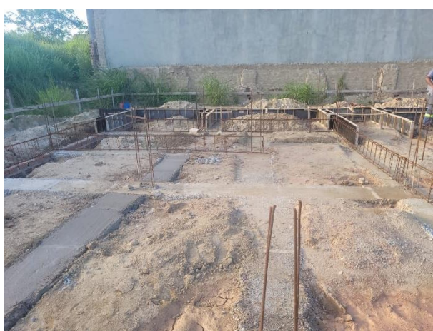
FOTO 5: Lastro de concreto magro, colocação das armações e montagem das formas para viga baldrame;
