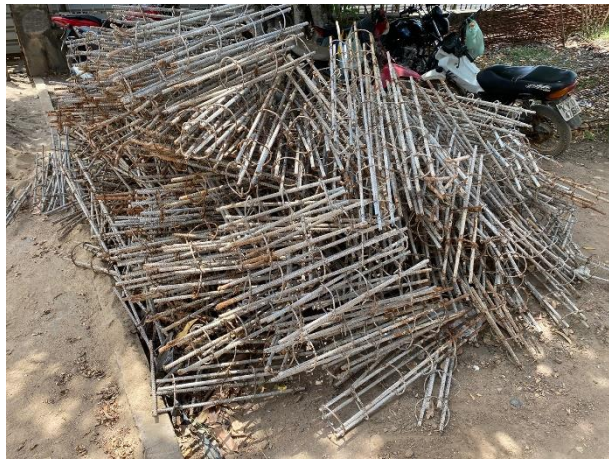
FOTO 9: Resíduos do arrasamento de estacas;
