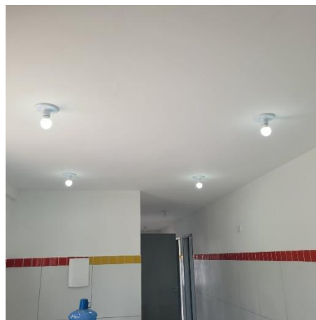
FOTO 16: Lâmpada compacta LED e pontos de tomadas;
