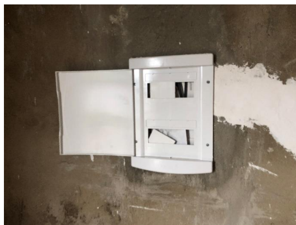
FOTO 12: Quadro de distribuição;
